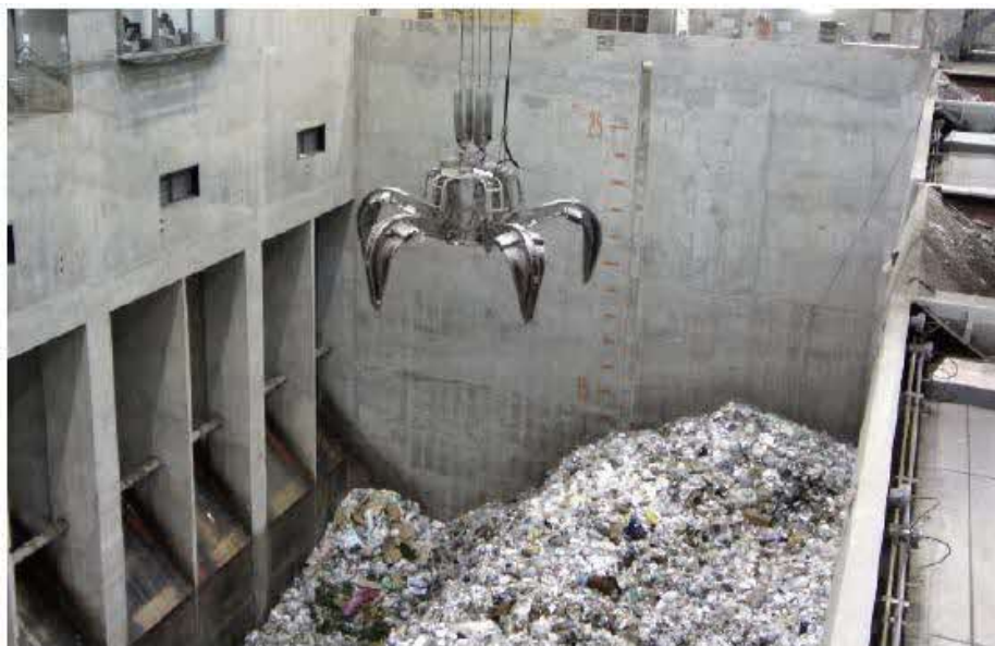
ごみバンクとごみクレーン (大田清掃工場)
