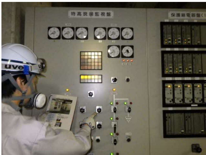
電気設備盤を点検している様子
