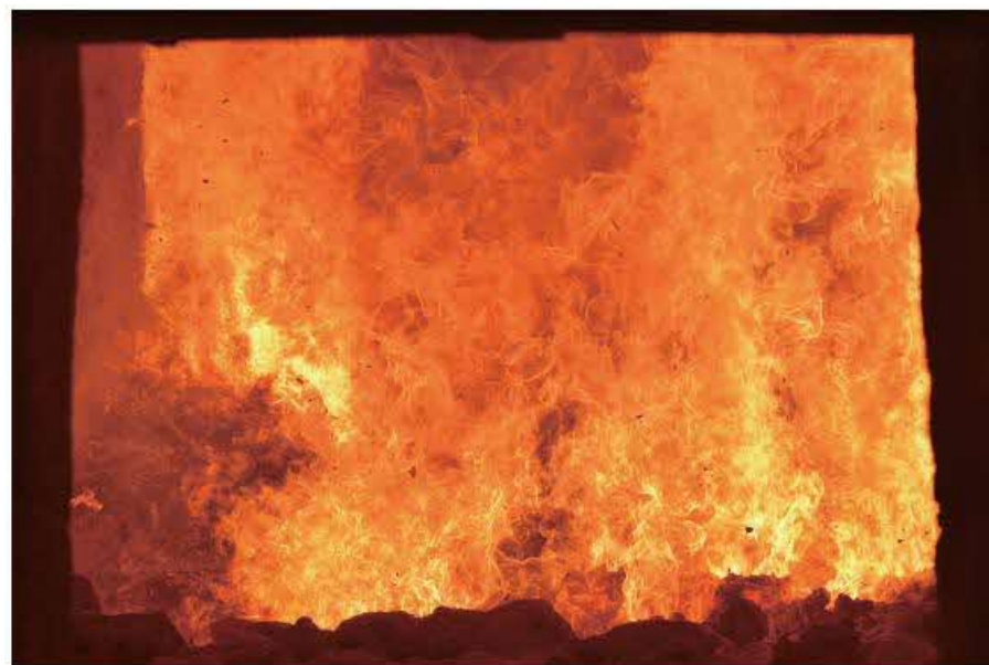
焼却炉内部の様子 (杉並清掃工場)
